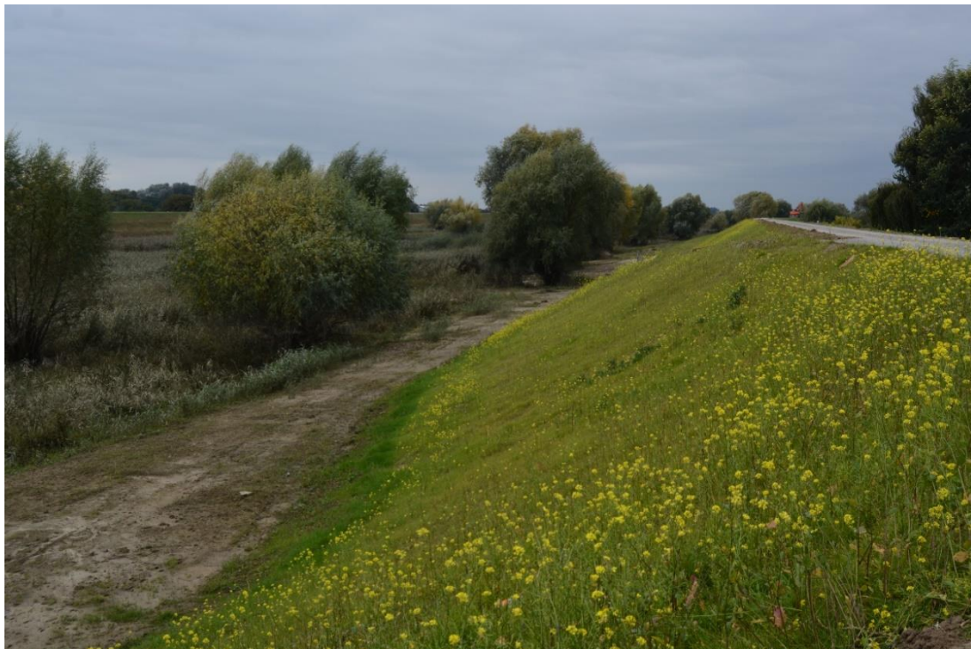
Fot.3. Przekształcenia gleb (mad brunatnych i czarnych ziem) w obrębie wałów wykonanych nad Koprzywianką (okolice Ostrołęki). Inwestycja o długości 13 km, realizowana jest w ramach projektu „Ochrona przeciwpowodziowa Sandomierza”. Obecnie trwają prace nad ostatecznym kształtem wałów i zagospodarowaniem terenu. (fot. A. Świercz)
